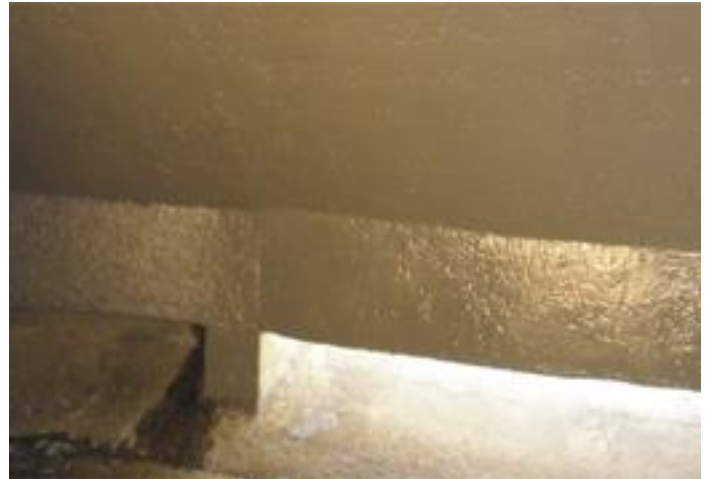
Aplicación manual de la membrana MasterSeal M 808, y acabado de la misma.
