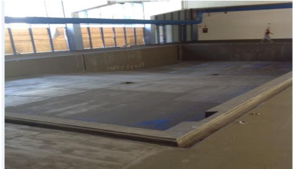
Impermeabilización vaso de hormigón de piscina cubierta von MasterSeal 550 del Polideportivo La Mina (Carabanchel)
