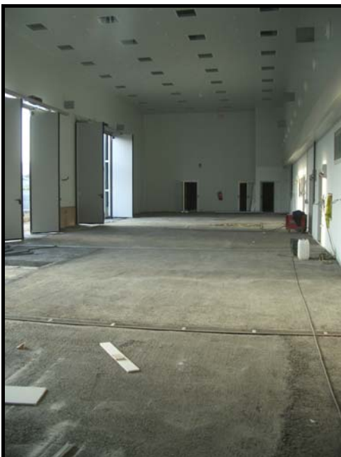
Estado del soporte tras el hormigonado.
